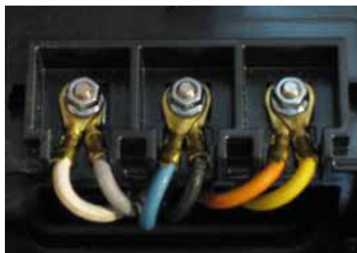
Рис. 39 Проводники электродвигателя подключены
